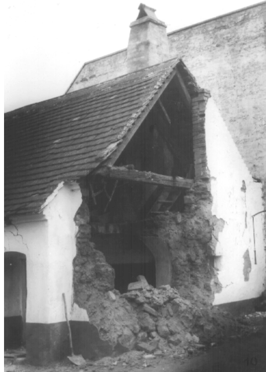
Schäden in Schwadorf im Jahr 1927
